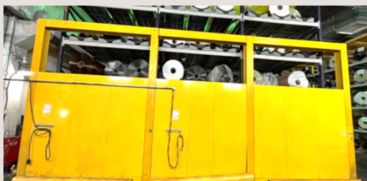
防撞桿經常遭堆高機碰撞 造成破損變形
